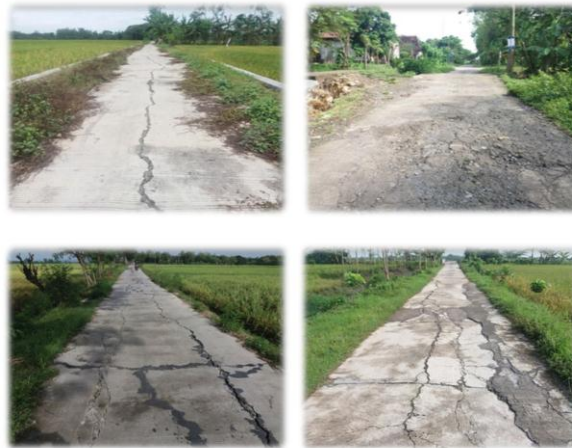
Gambar 1. Foto kerusakan jalan desa di Kecamatan Dempet Kabupaten Demak
