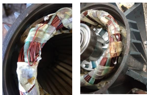
Gambar 2. Kerusakan isolasi belitan trun on trun
