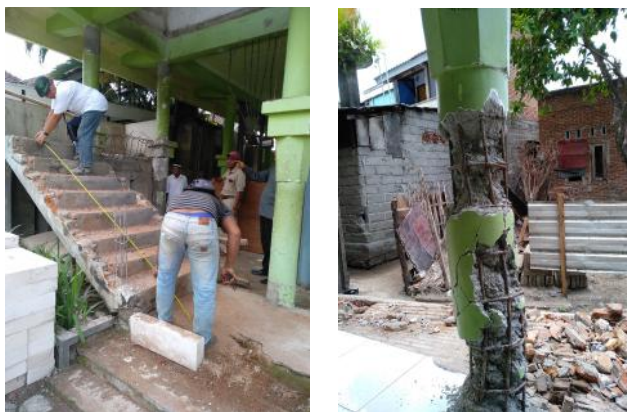
Gambar 2. Kondisi Bangunan Pasca Gempa Lombok
