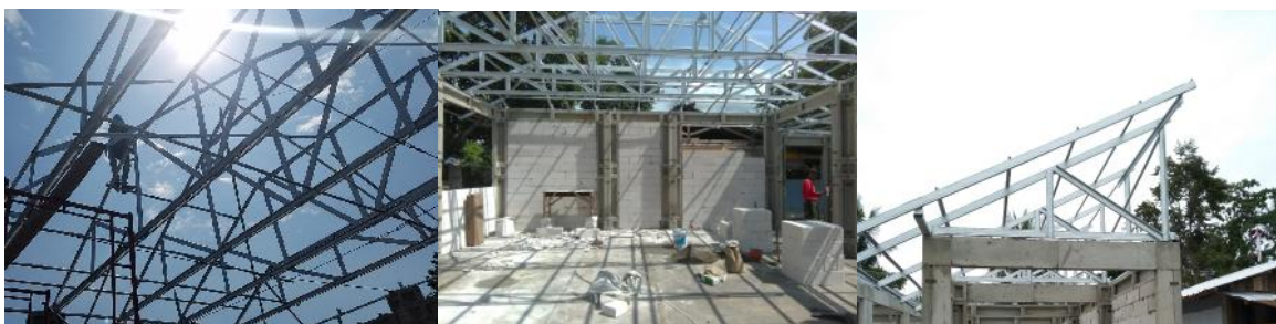
Gambar 5. Perbaikan struktur Baja yang mengalami kerusakan (PT. Indra Karya, 2019)
