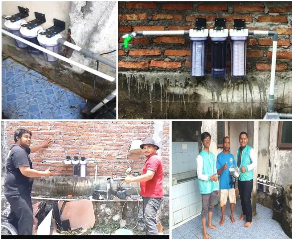
Gambar 6. Alat Filtrasi yang terpasang di beberapa titik lokasi PKM
